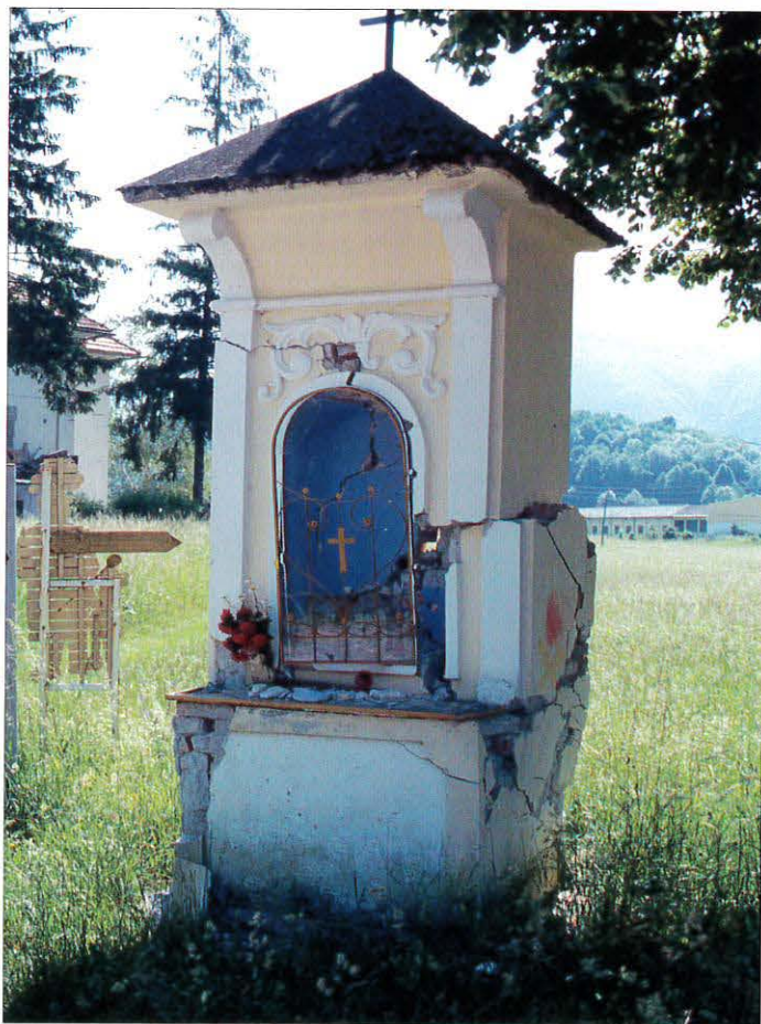
Sl. 2.16. Kapelica v Bovcu, poškodovana med velikonočnim potresom leta 1998. Stanko Buser
